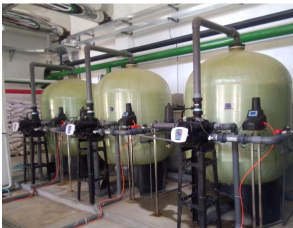
图 1-27 沈阳某公司 120m³/h 软化水系统
