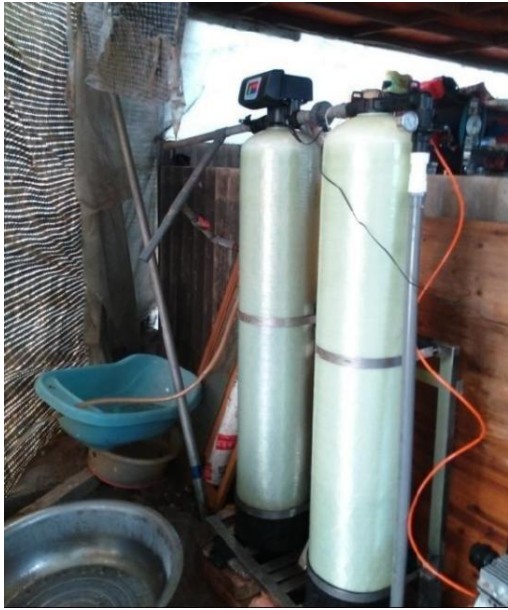
图 1-46 福建漳州某园艺种植场除铁锰装置
