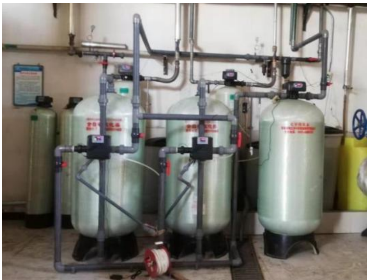
图 1-50 N75A 自动过滤阀应用于兰州某制药工厂除氧系统
