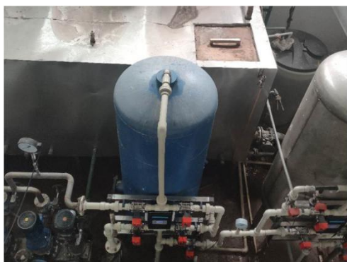
图 1-42 沈阳某制药厂热消毒水处理设备
