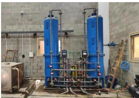
图 1-43 埃及某工业化肥公司超纯水设备
