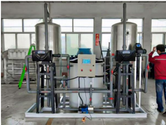
1-60 集中供热换热站软水设备
