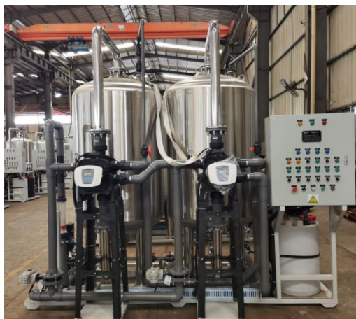
图 1-26 东莞某公司农村饮用水改造设备
