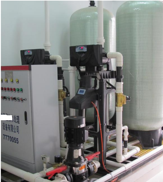
图 1-28 F95C3 应用于 山东东营某热力公司软化水处理系统
